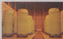
日本原子力発電(株)東海第二発電所での乾式貯蔵
